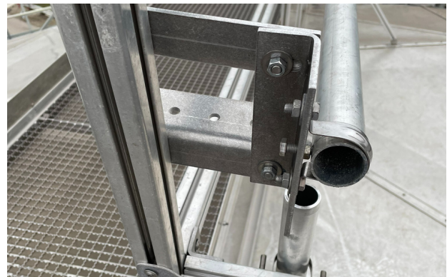
Conduit Piping (power supply)
